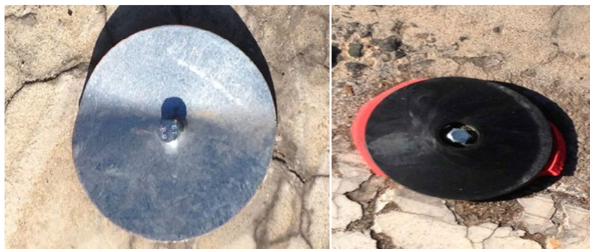
Anclaje de baliza tradicional que queda en la calzada tras ser destruida la baliza.
